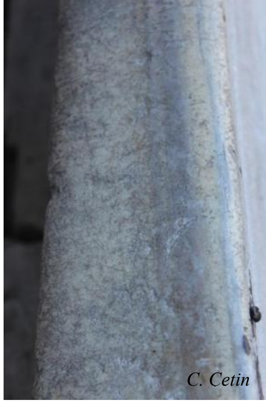
Resim 14. Yeni Camii'de erozyon sonucunda yüzeyi parlayan mermer bir parapet, İstanbul (C. Çetin)
