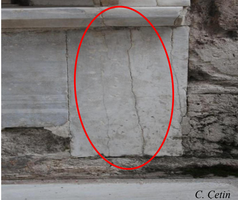
Resim 3. Sadr-i Esbak Seyyid Hasan Paşa Medresesi Sebili mermer yapı elemanı üzerinde kılcal çatlaklar, İstanbul 2012, (C. Çetin).
