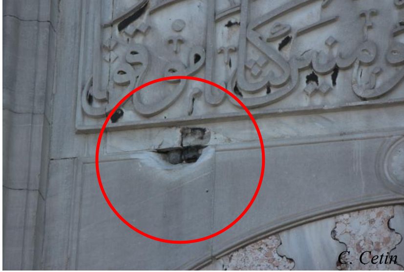
Resim 7. Yeni Camii'de mermer yapı elemanı içinde bulunan metal zıvananın korozyonu sonucunda oluşan patlama, İstanbul 2012 (C. Çetin)
