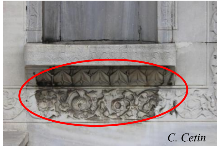
Resim 3. III. Ahmet Çeşmesi'nde denizlik altındaki bölgede siyah tabaka oluşumu, İstanbul 2015 (C. Çetin)
