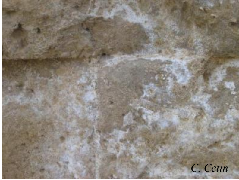
Resim 5. Büyük Han'da restorasyonu yapılmış bir duvarda tuzlanma, Lefkoşa 2008 (C. Çetin)
