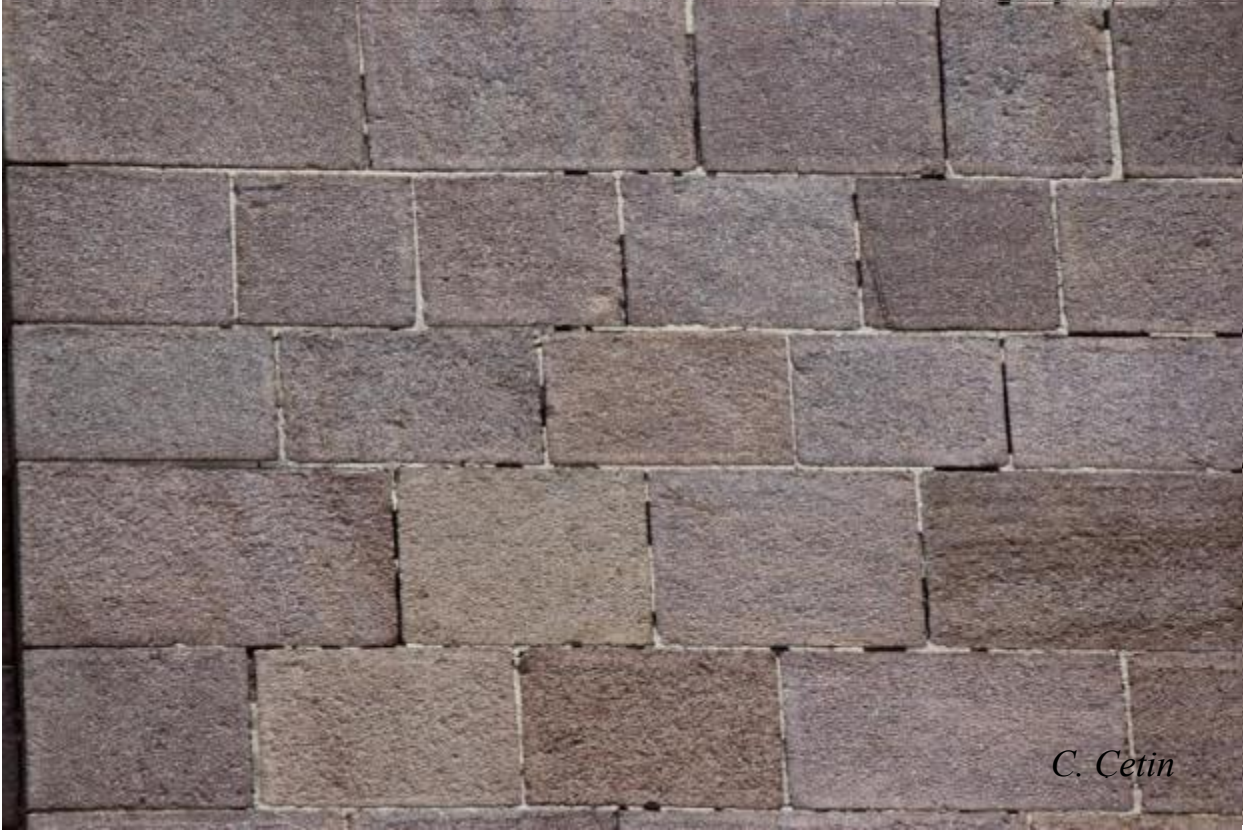
Resim 22. Andezit bloklarla örülmüş bir duvarda, aynı tür fakat farklı renk tonlarında taşlar, Ankara, Ziraat Fakültesi, 2011 (C. Çetin)
