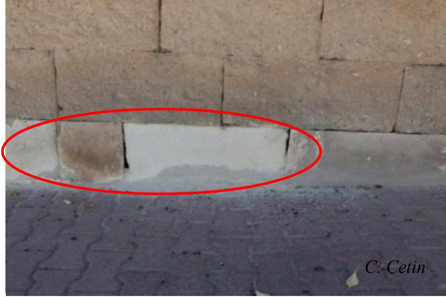
Resim 15. Mustafa Paşa M.Y.O. binasının temelinde tuf taşlarda tozlaşma, Nevşehir 2012 (C. Çetin)
