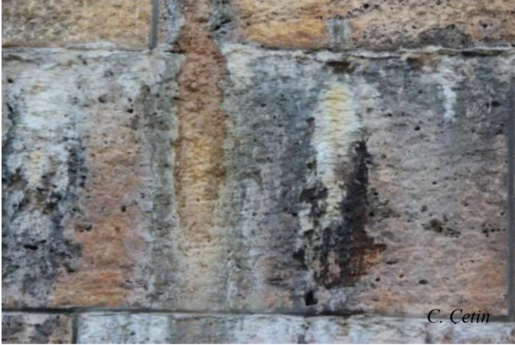
Resim 6. Anıtkabir teras duvarında kalsiyum karbonat birikimi, Ankara 2012 (C. Çetin)
