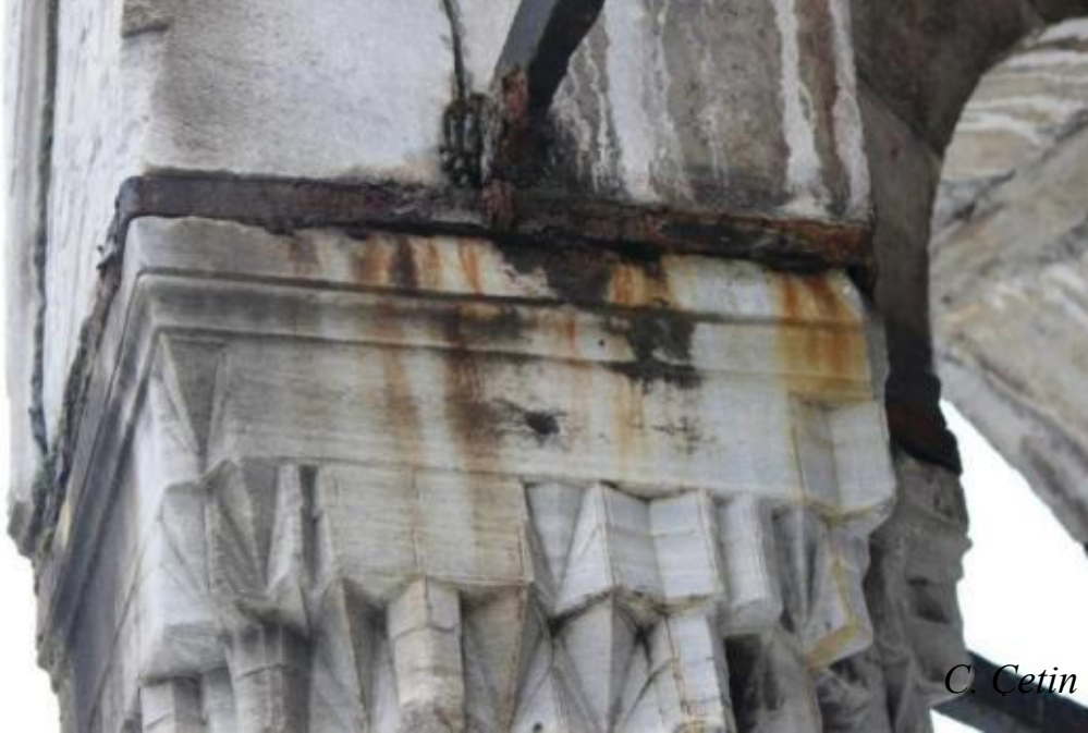
Resim 21. Sultan Ahmet Camii'nin beyaz mermer sütun başlığının demir kasnağının korozyonunun üzerine akması sonucu renk bozulması görülüyor, İstanbul, 2015 (C. Çetin)
