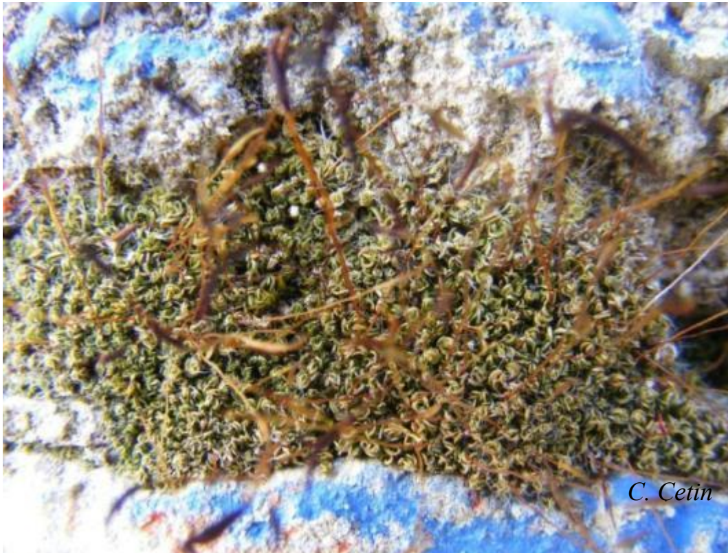
Resim 10. Andezit bloklardan örülmüş bir duvarın derzinde gelişmiş yosun kolonizasyonu, Ankara, Beypazarı 2011 (C. Çetin)
