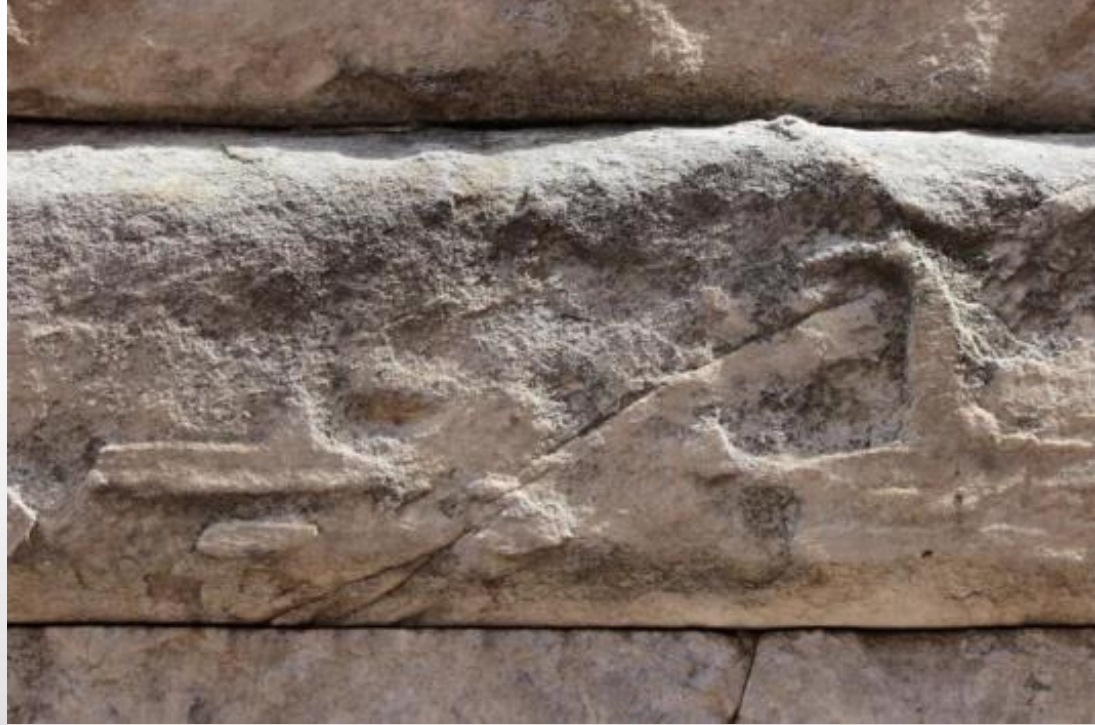
Ankara Augustus Tapınağı mermer yapı elemanında görülen hasar. (C. Çetin, Ankara, 2015)
