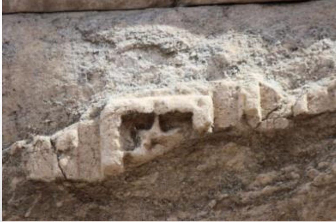
Ankara Augustus Tapınađı mermer yapı elemanında atmosferik bozulma sonucunda oluşan tahribat. (C.Çetin, Ankara 2015)
