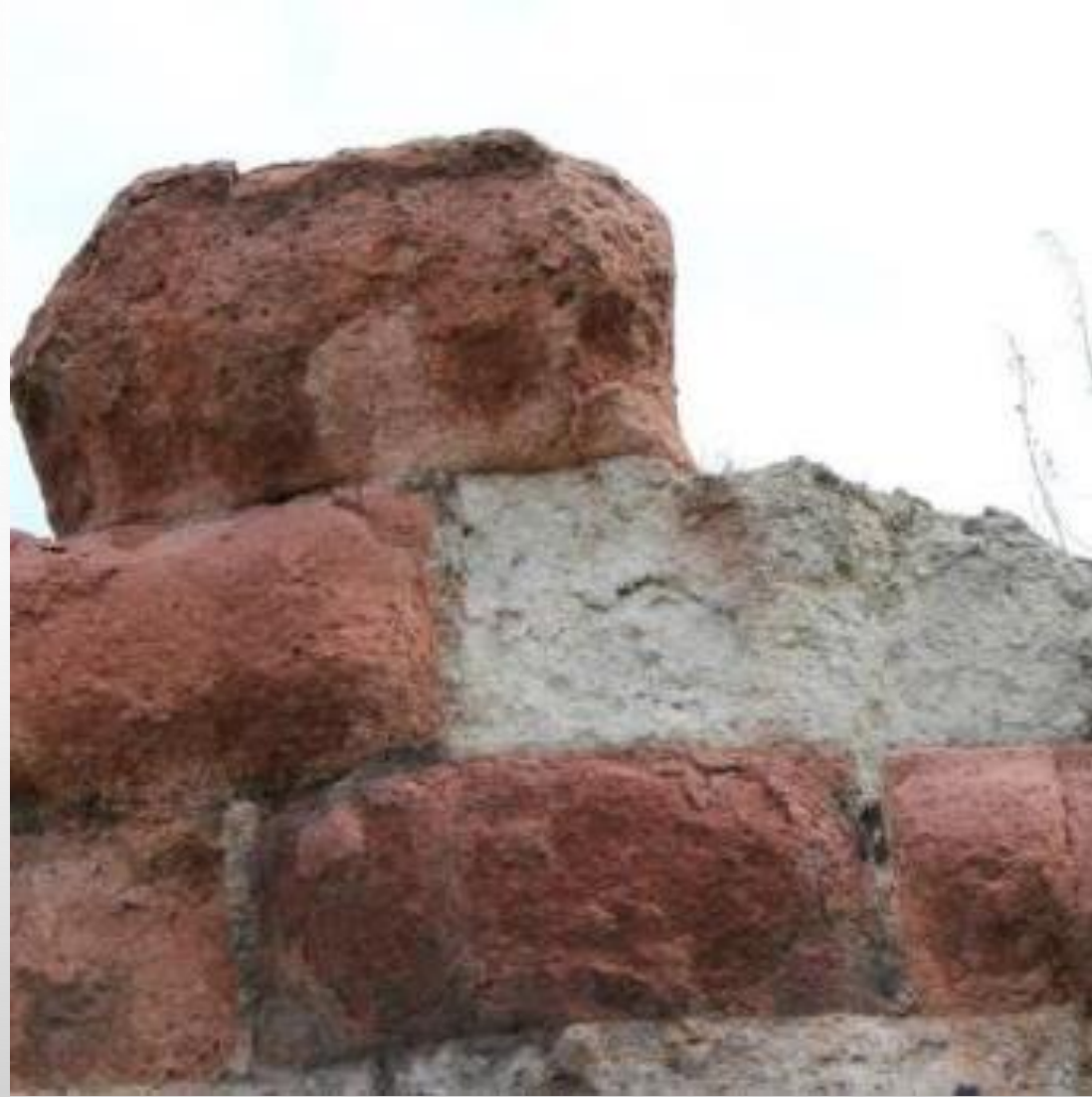
Ankara Augustus Tapınağı duvar bloklarında görülen tahribat. (C. Çetin, Ankara, 2015)
