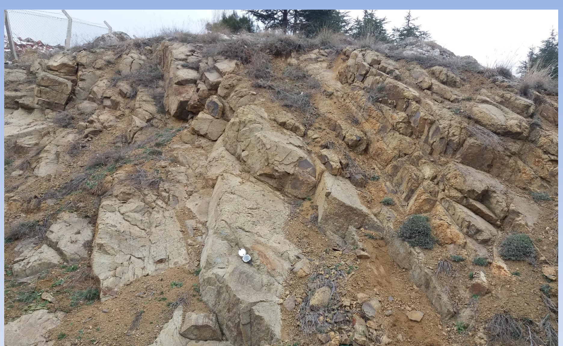
Altındağ, Cinderesi Miyosen Andezit Kütlesi İçinde Şeve Paralel Düzlemler
