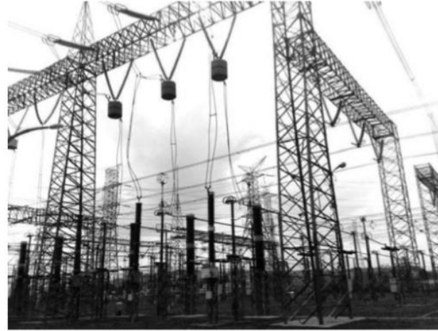
Resim 3.1: Şalt sahası ve elemanları.
