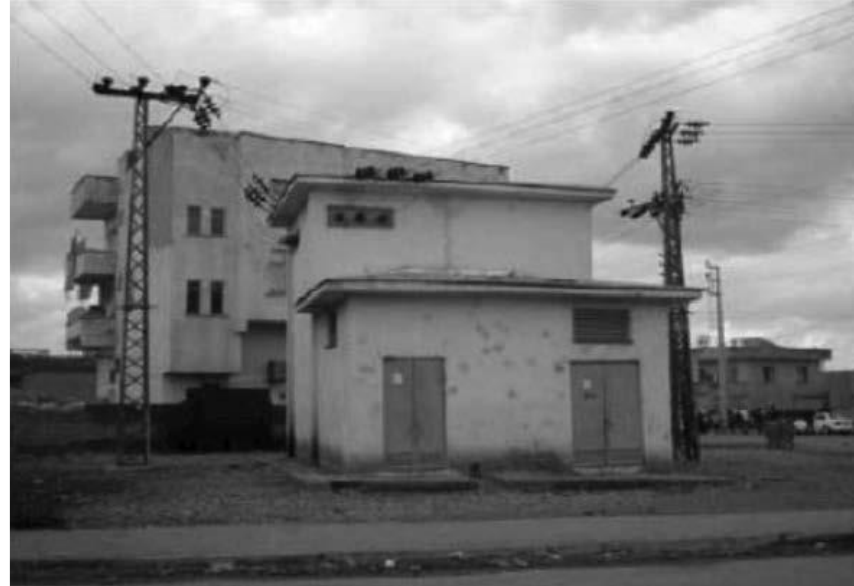
Resim 6.4: Bina tipi dağıtım transformatörü.
