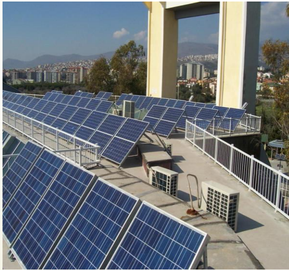
Şekil 4.31 Dağıtık şebeke bağlantılı fotovoltaik güç sistemi (Anonim 2012b)
