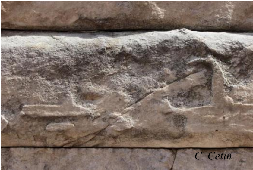
Resim 3. Ankara Augustus Tapınağı mermer yapı elemanında görülen hasar. (C. Çetin, Ankara, 2015)
