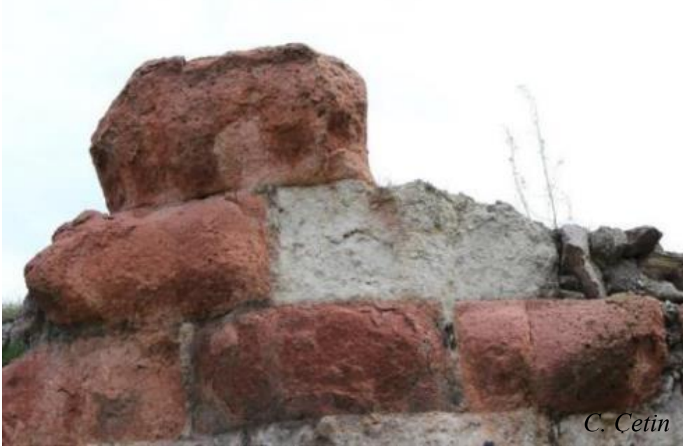
Resim 4 . Ankara Augustus Tapınağı duvar bloklarında görülen tahribat. (C. Çetin, Ankara, 2015)
