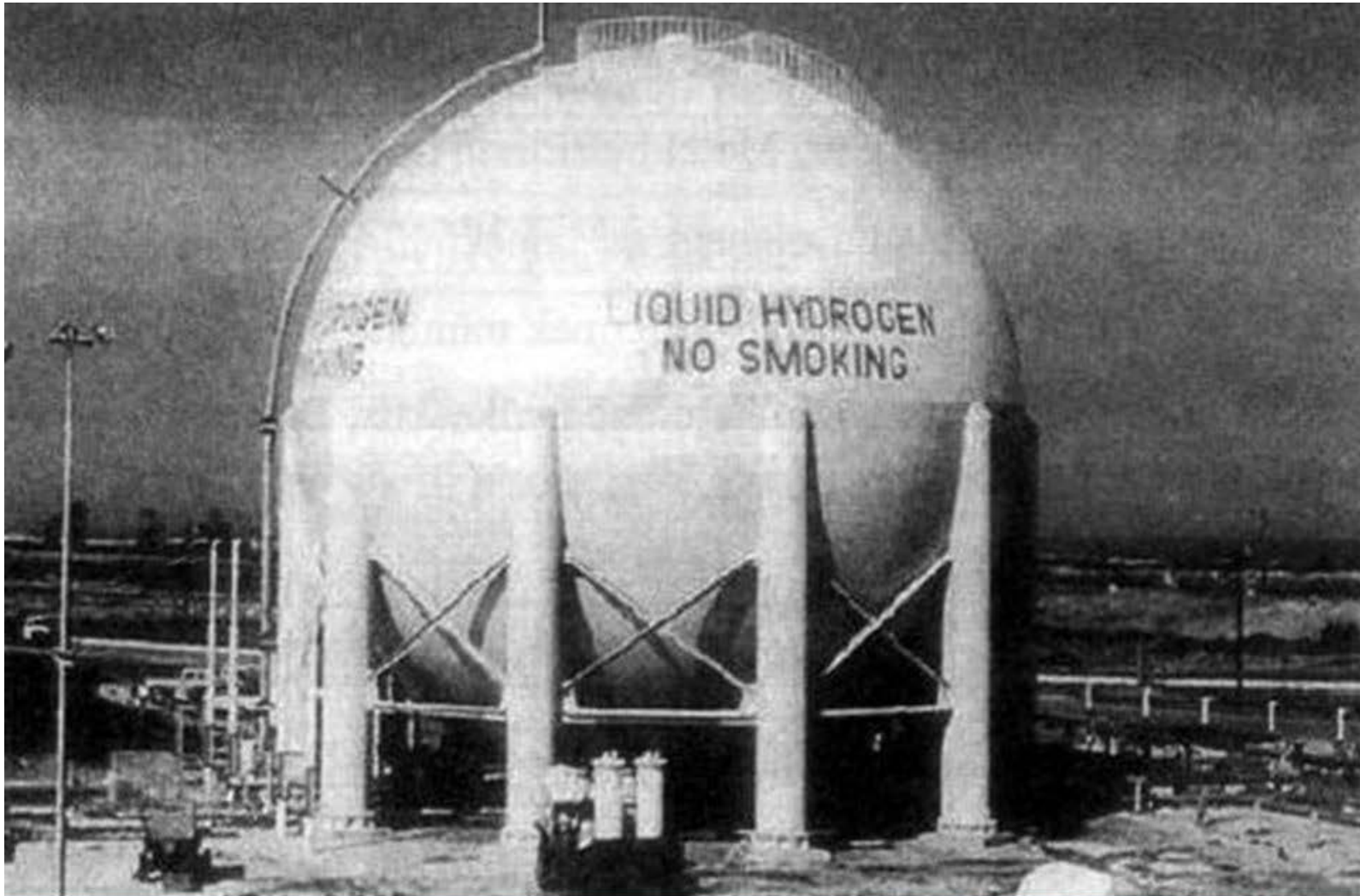
SIVI hidrogen deposu
