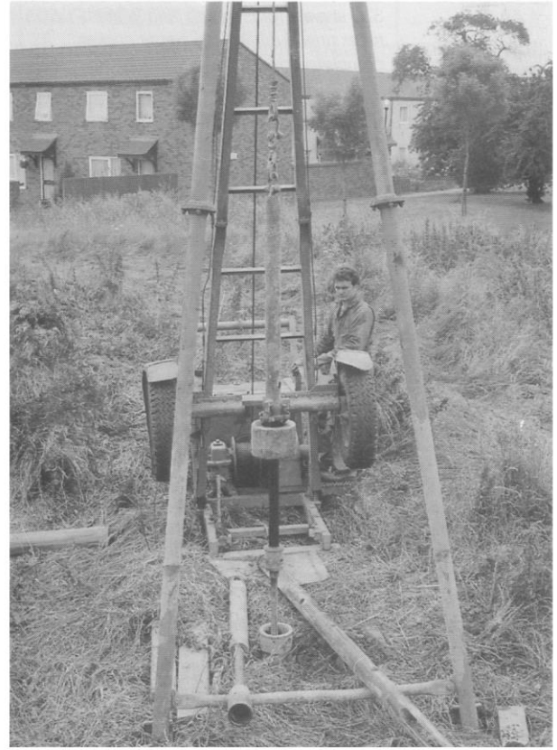
Debyshire'da bir inşaat projesi için hafif darbeli sondaj ile 10 m derinliğe kadar numune alımı
